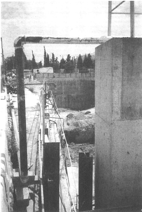
Ύπο την εκτέλεση των έργων για τον σταθμό «Κεραμεικός» του υπογείου σιδηροδρόμου. Στο βάθος διακρίνονται τά ταφικά μνημεία και μπροστά οι σωλήνες τής γεώτρησης (Antike Welt 27, 1996, 170, abb. 3).
