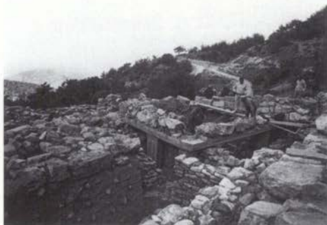
279. Σύμη Βιάννου, ἱερὸ Ἑρμῆ καὶ Ἀφροδίτης, 1995. Ἔργασίες ἀναστήλωσης τοῦ μετανακτορικοῦ κτιρίου Q (ΠΑΕ 1995, πίν. 109α).
