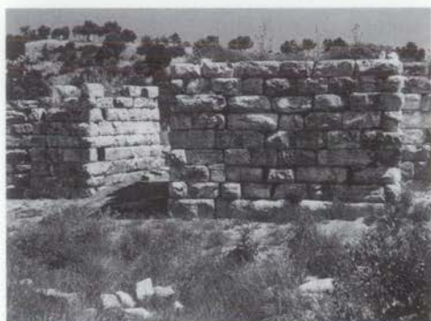
295. Ραμνούς, 1994. Ἡ νότια πύλη τοῦ φρουρίου, τοῦ 5ου π.Χ. αἰ., ἀναστηλωμένη (Ραμνούς I 54, εἰκ. 18).
