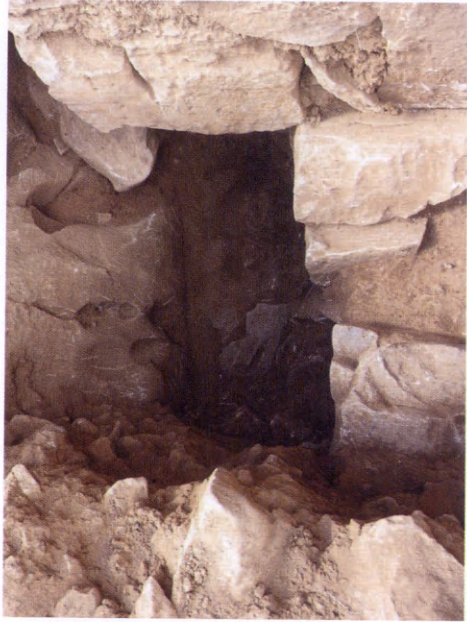
29 Ἁγ. Ἀνδρέας Σίφνου. Περιοχή μυκηναϊκῆς οἰκίας Η, ὁ Χῶρος 10 (Συγκρότημα Ν). Ὁ ὀμβροδέκτης.
