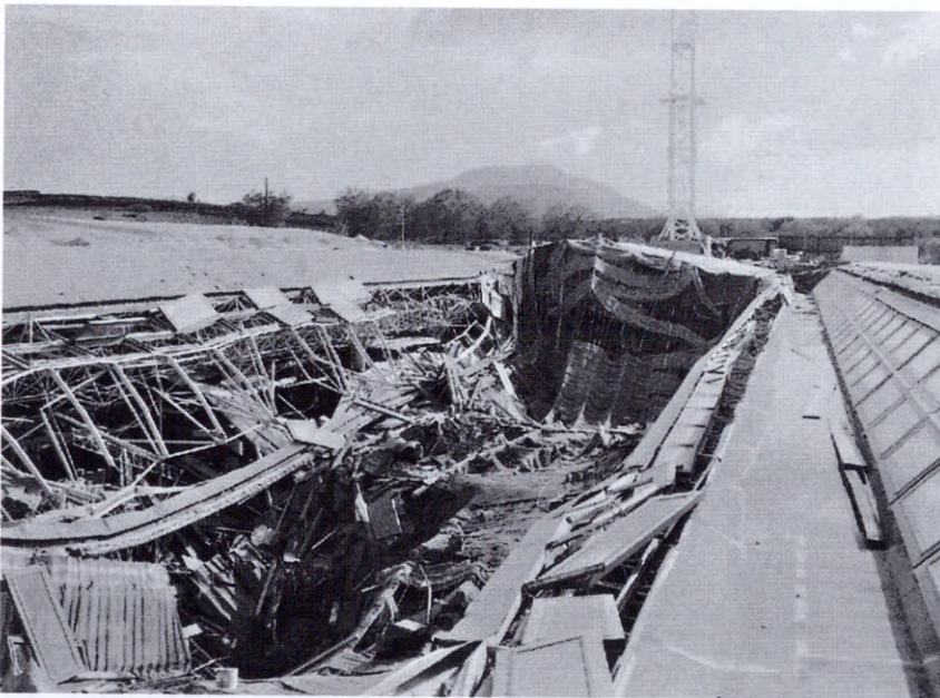
74 Τὸ τμήμα τοῦ στεγάστρου πὸ κατέρρευσε.
