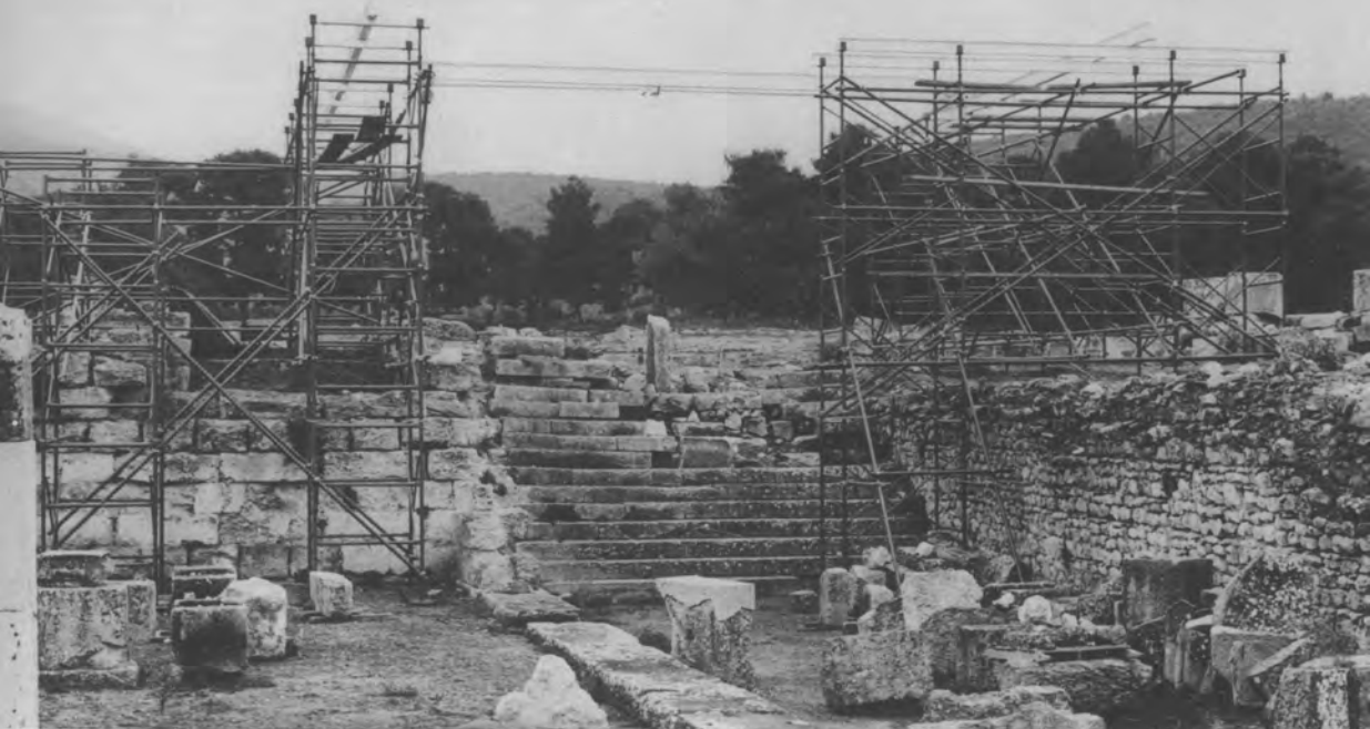
144 Ἡ γερανογέφυρα στὸ Ἄβατο.
