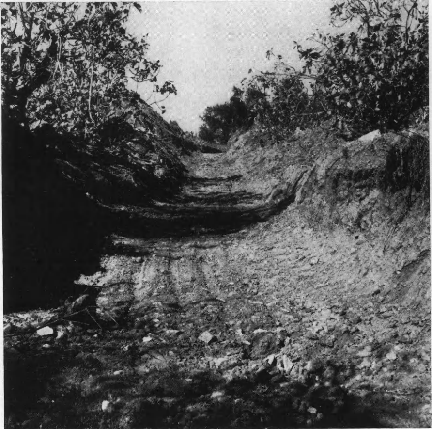
Εἰκ. 243. Ὁ ἀνοιχθεὶς εἰς ἀντικατάστασιν τοῦ διαρρέοντος τὴν «Ἀγορᾶν» χειμάρρου νέος ἀποχετευτικὸς χάνδαξ.
