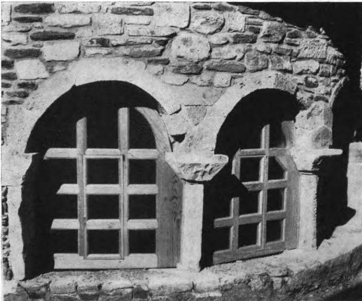
Εἰκ. 151. Τὸ τρίλοβον παράθυρον τῆς ἀψίδος τοῦ Ἁγ. Νικολάου μετὰ τὰς ἐργασίας ἀποκαταστάσεως αὐτοῦ. (Φωτογρ. Χ. Σφακιανᾶκη)
