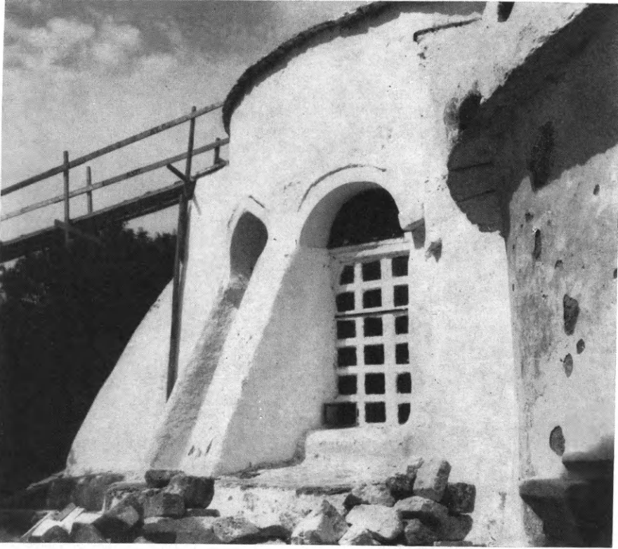
Εἰκ. 216. Ἡ ἀψὶς τοῦ ἱεροῦ τοῦ ναοῦ τῆς Καταπολιανῆς πρὸ τῆς κατεδαφίσεως τῶν ἀντηρίδων καὶ τῆς ἀποκαταστάσεως τοῦ τριλόβου παραθύρου αὐτῆς.
