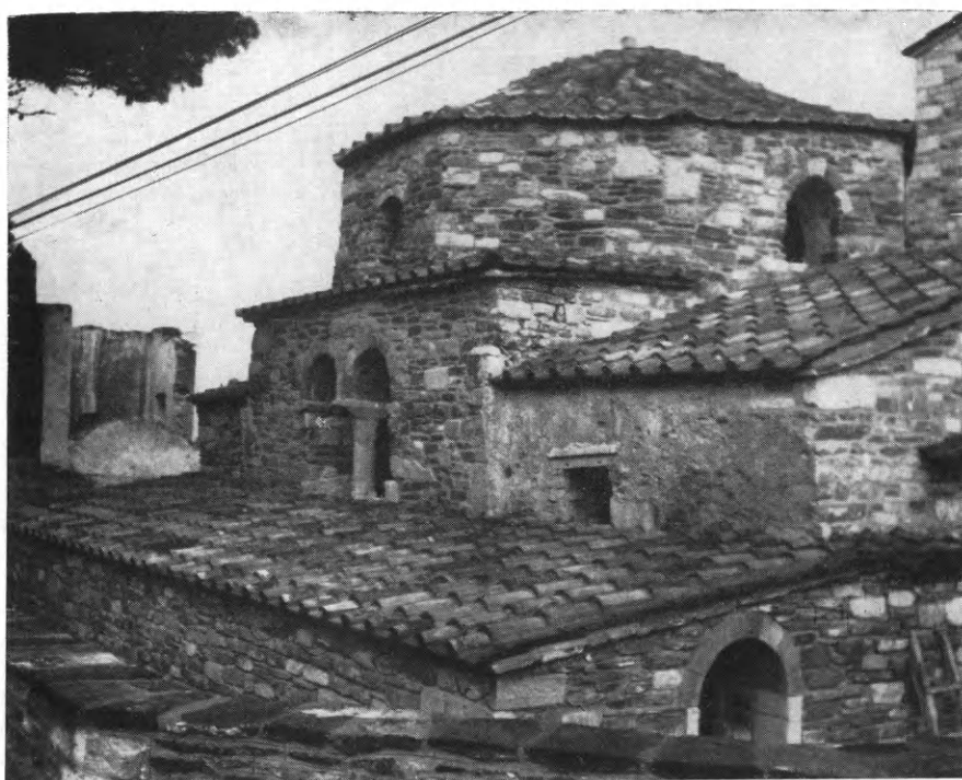
Εικ. 222. *Άποψις τοῦ βαπτιστηρίου τῆς Καταπολιανῆς ἀπὸ ΝΑ. μετὰ τὰς ἐργασίας ἀναστηλώσεως καὶ ἀνακεραμώσεως αὐτοῦ.
