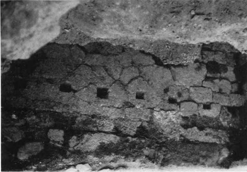
Εἰκ. 131. Σειρὰ ὀπῶν εἰς τὸ ἐσωτερικὸν τοῦ τοίχου τῆς δυτικῆς πλευρᾶς τοῦ εὐρεθέντος νέου μεγάλου καὶ ἀγνώστου προορισμοῦ οἰκοδομήματος.
