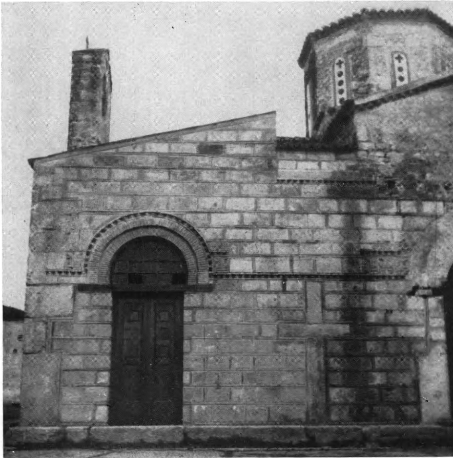
Εἰκ. 205. Ναὸς Χώνικα. Ἡ νοτιὰ ὄψις τοῦ νάρθηκος μετὰ τὴν ἀναστήλωσιν αὐτοῦ.
