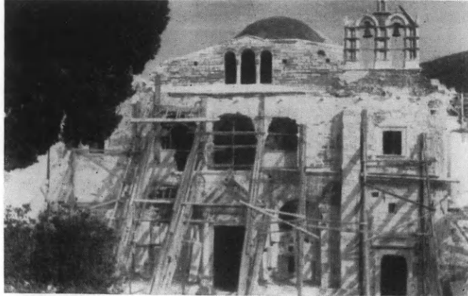
Εἰκ. 286. Ἡ πρόσοψις τοῦ ναοῦ τῆς Καταπολιανῆς κατὰ τὴν διάρκειαν τῶν ἐργασιῶν ἀναπαλαιώσεως αὐτῆς.
