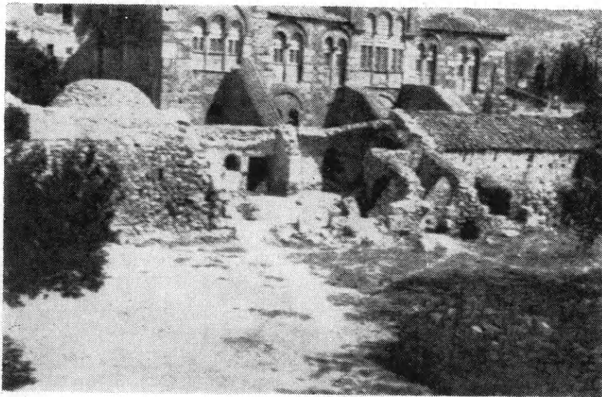
Είκ. 96. Ἡ Τράπεζα τῆς Μονῆς Ὁσίου Λουκά κατὰ τὴν ἔναρξιν τῶν ἐργασιῶν ἀναστηλώσεως αὐτῆς.
