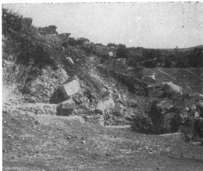
Εἰκ. 138. Ὁψις τοῦ ἄκρου τοῦ ἀνατολικοῦ ἄνω διαζώματος πρὸ τῶν ἐργασιῶν ἀνακατασκευῆς αὐτοῦ.
